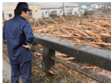
流木にせき止められた玉来川(竹田市)
