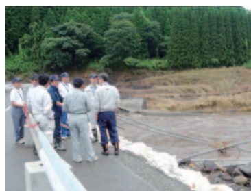
欄干が流された猿飛橋(豊後大野市)
